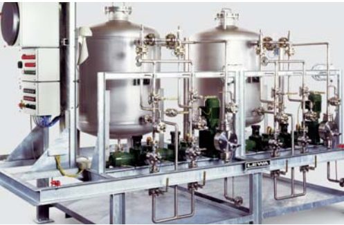
Auch mit Ex-Schutz: Anlage zur Prozesswasser- Aufbereitung in einer Raffinerie
