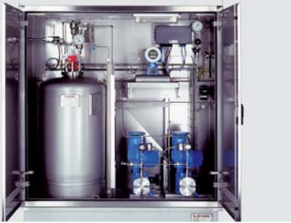
Mengenproportional: Exakt überwachte Geruchsstoff-Zugabe z. B. bei der Erdgasversorgung
